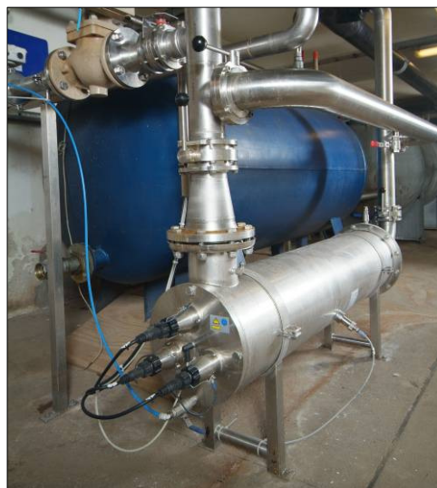
UV anlæg type Spektron 70 med en ydelse på 108 m 3 /h. Anlægget er installeret på et dansk mejeri.
