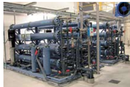
Omvendt osmoseanlæg type RO 03-18 til fremstilling af kedelvand hos AstraZeneca, Sverige.
