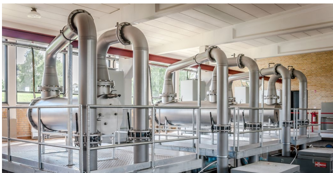
Desinfektion af drikkevand med UV på Sjælsø Vandværk. Anlægget er installeret som en ekstra sikkerhed mod bakterielogisk forurening.
