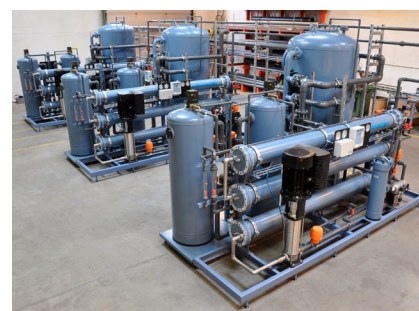
Rammemonteret anlæg til produktion af afsaltet vand til køling af Facebooks datacenter i Sverige.
